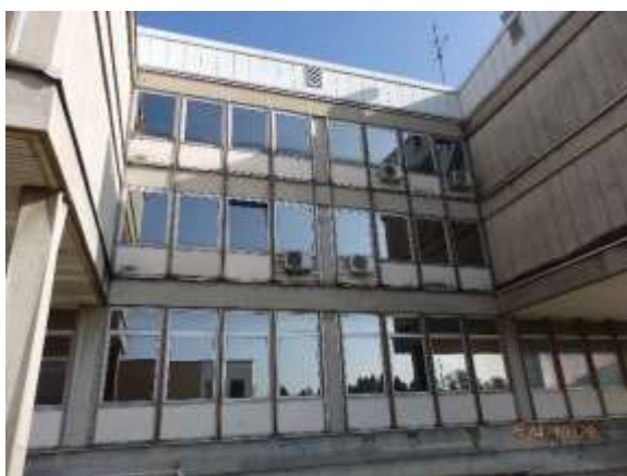
Slika 2. Vanjske jedinice klima uređaja na fasadi – jugozapad
