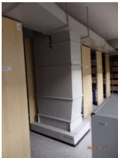
Slika 14. Ventilacijski kanal vertikalni u spremištu arhivske građe
