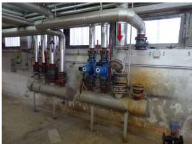
Slika 12. Razdjelnik i sabirnik s priključkom za klima komore
