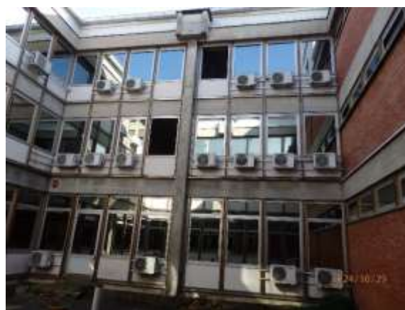
Slika 3. Vanjske jedinice klima uređaja u prostoru Atrija – jugoistok
