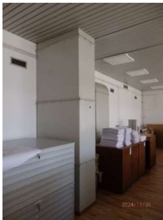
Slika 17. Ventilacijski kanal vertikalni – prolaz kroz resturatorsku radionicu za spremište arhivske građe
