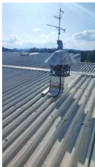
Slika 6. Centrifugalni ventilator na krovu zgrade
