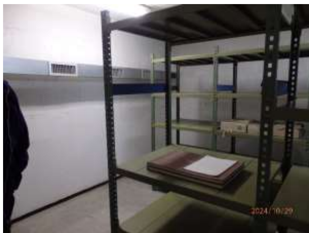
Slika 4. Ventilacijski kanali u Sklonište za mikrofilmove
